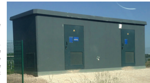
Exemple de poste de livraison peint en vert foncé (crédit photo : Urbasolar)
