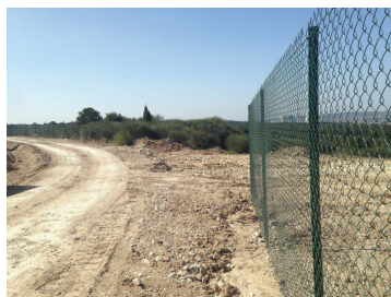
Exemple de clôture en maille souple, verte (crédit photo : Urbasolar)
